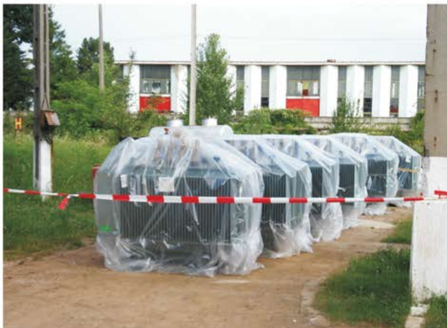
transformatoare 20/04kV, 1600KVA - producător France Transfo/Schneider Electric- Franța
