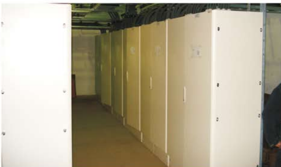
echipament electric de 0,4kV- producător Van Egmond - Olanda
