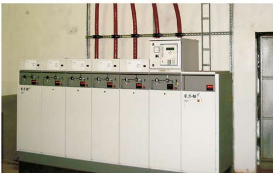
echipament electric de 20kV- producător Eaton Holec - Olanda
