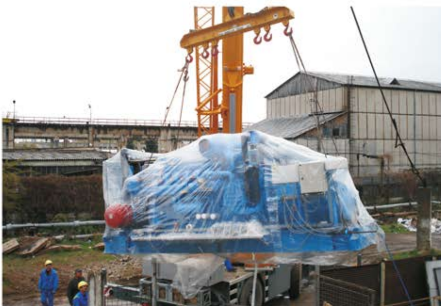
8 motoare termice pe gaze tip 4016TES1140HC - producător PERKINS - Marea Britanie, echipate cu generatoare HC 634K2 - producător STAMFORD - Marea Britanie (5 motoare termice au fost instalate în anul 2006, restul de 3 motoare au fost instalate în 2007)
